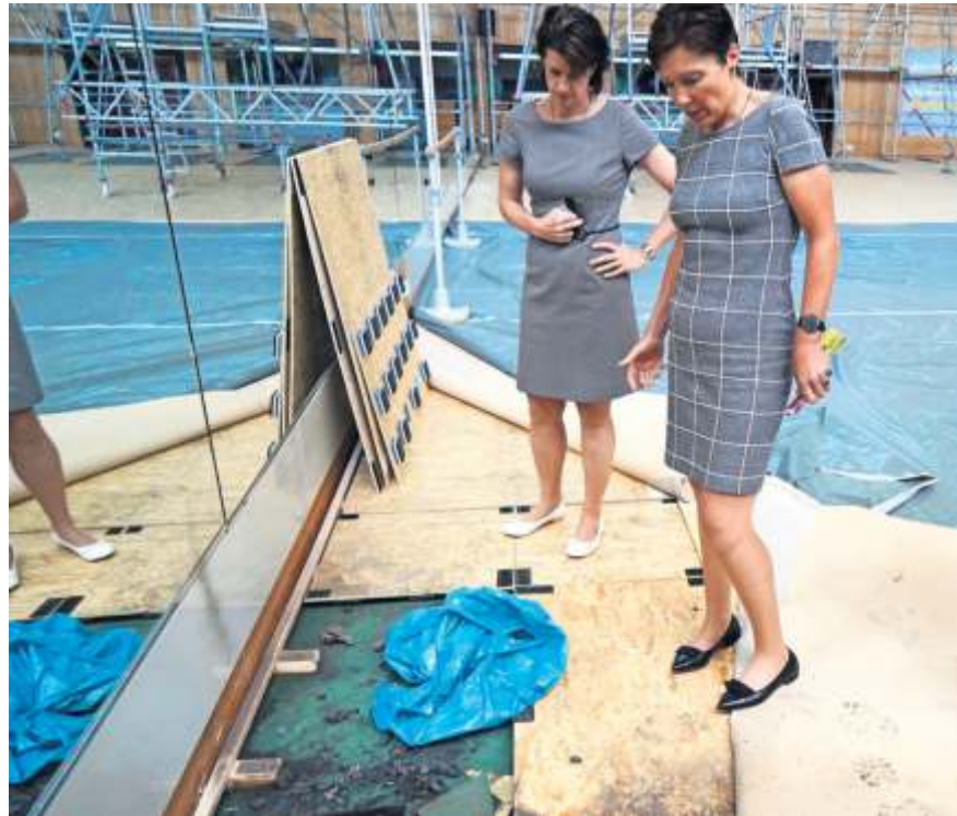
OB Gabriele Zull (li.) und Baubürgermeisterin Beatrice Soltys bei der Besichtigung der Wasserschäden. Foto: Laartz
