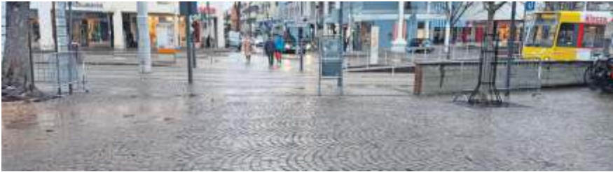
Am Montag, 21. Januar gehen die Arbeiten bei der Lutherkirche los. Foto: Laartz
