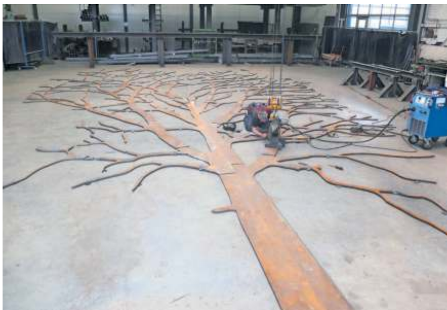
Bei Stahlbau Jerger in Waiblingen nimmt die mächtige Eiche aus Stahlteilen jetzt wieder Gestalt an. Foto: Knopp
