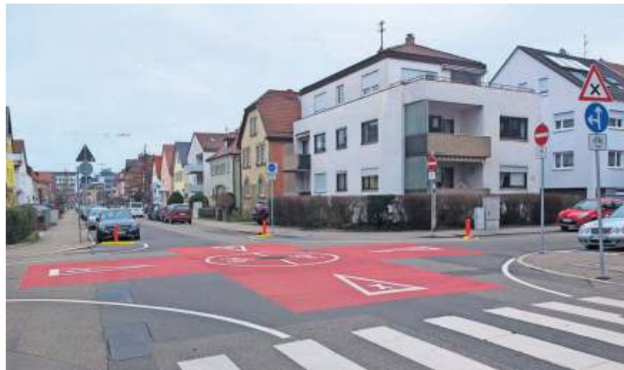
An der Kreuzung Theodor-Heuss-Straße/Wernerstraße wird im Zuge der Bauarbeiten ein Kreisverkehr eingerichtet. Foto: Knopp
