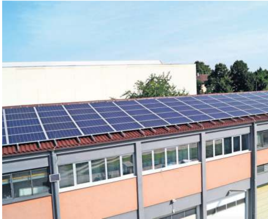
Auch auf dem Dach des städtischen Bauhofs wurde eine Photovoltaik-Anlage installiert.
