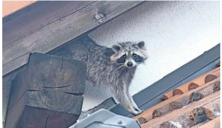
Der Waschbär sieht niedlich aus, kann aber großen Schaden anrichten, wenn es sich unterm Hausdach einrichtet.
