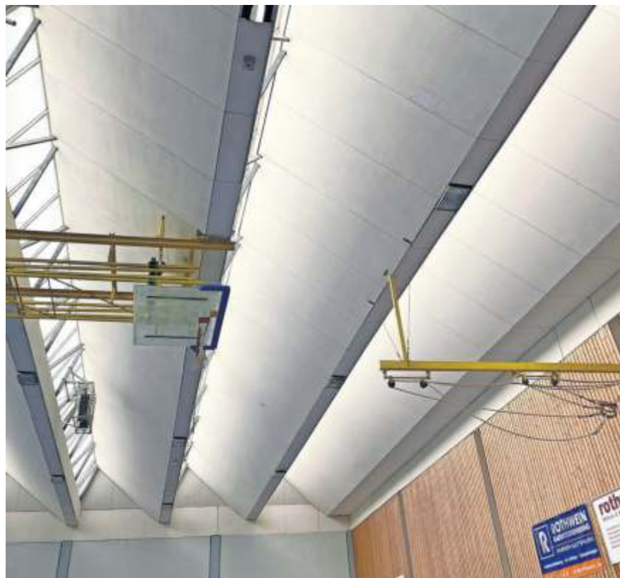
Die Deckenkonstruktion wies Mängel auf.
